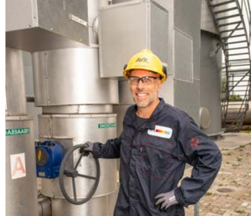
Robert Hageman, operations manager bij afvalenergiecentrale AVR
